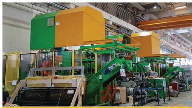
Cappe su presse collegate ad impianto centralizzato di aspirazione e filtrazione – Uzbekistan
