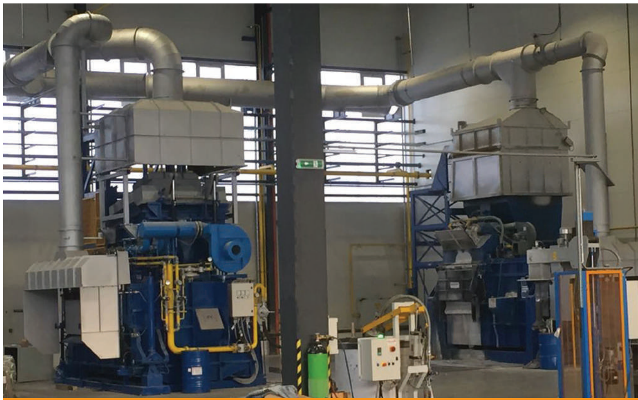
Cappe su bocche di combustione e porte di scorifica di forni fusori alluminio – Slovacchia
