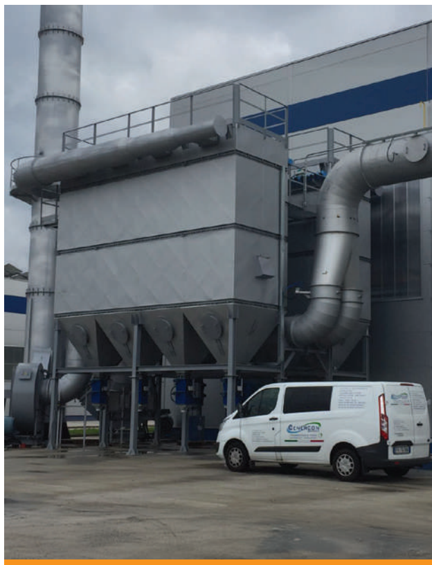
Impianto di aspirazione e filtrazione da 85.000 m 3 /h per trattamento fumi da forni fusori alluminio – Slovacchia
