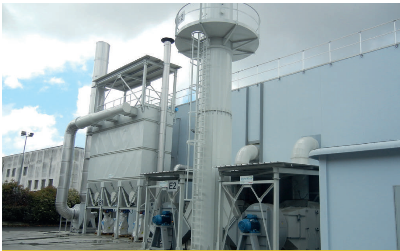
Impianti di aspirazione completi per pressofusione, a sx impianto aspirazione e filtrazione per forni fusori ed aspirazione per forni d'attesa, a dx impianto di Impianto di aspirazione e filtrazione centralizzato da 80.000 m 3 /h a servizio di n.9 presse con filtro speciale a coalescenza in tecnopolimero – Italia
