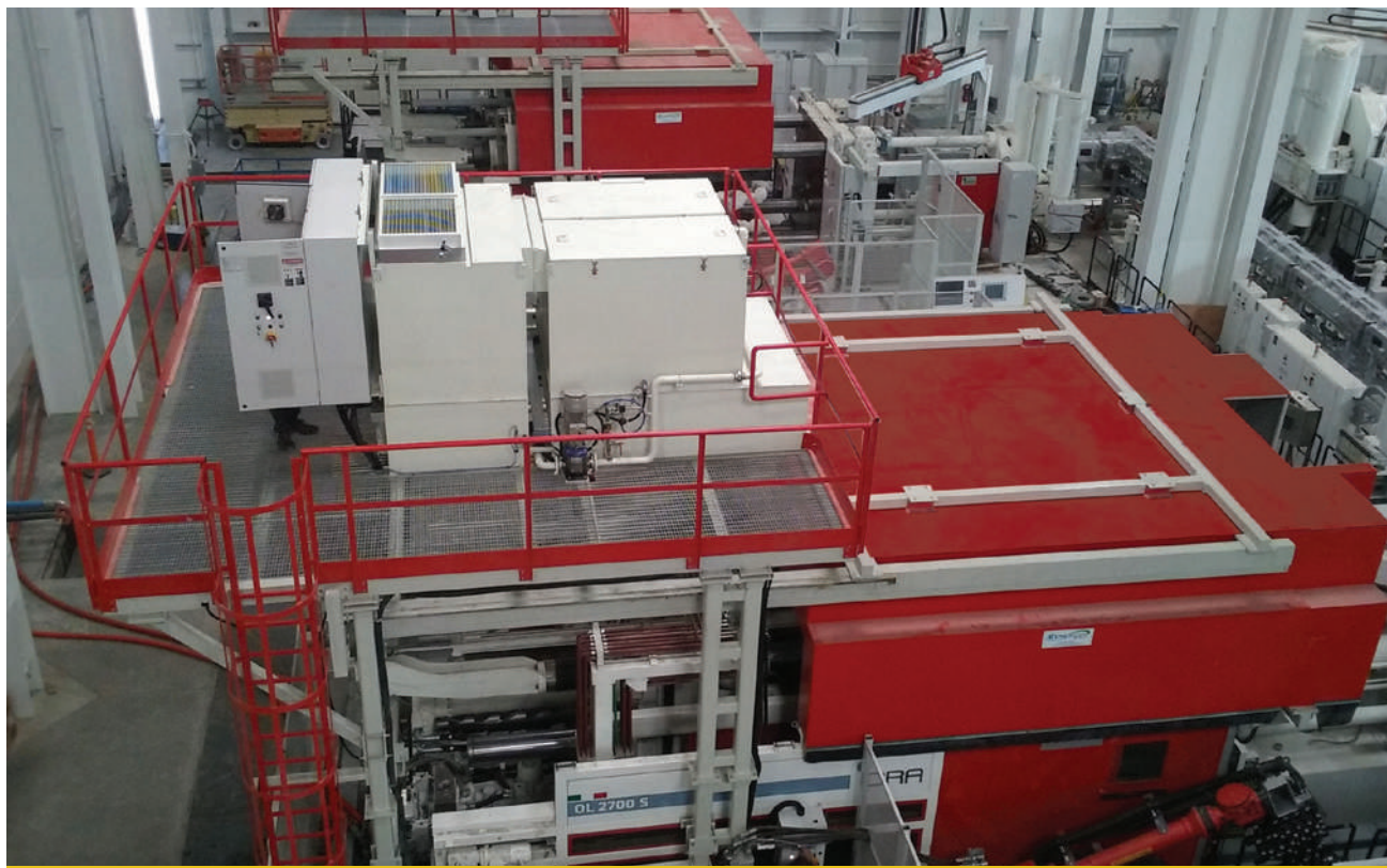
Cappe in due parti complete di impianti individuali di aspirazione e filtrazione ENERPRESS per il riciclo dell'aria depurata in ambiente su macchine di pressofusione IDRA OL4200S e OL2700S – USA
