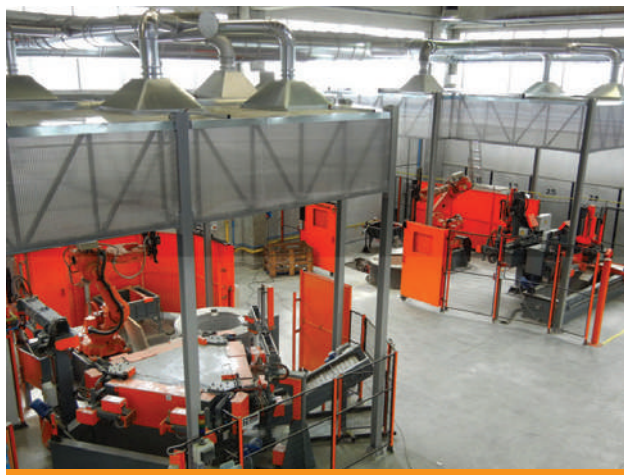
Cappe di aspirazione su conchigliatrici collegate ad impianto di aspirazione e filtrazione centralizzato – Italia
