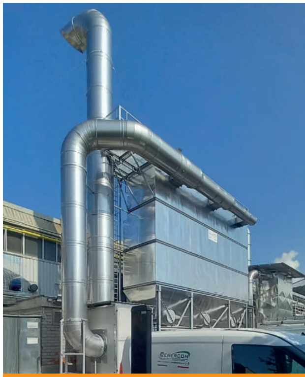
Impianto di aspirazione e filtrazione – Italia
