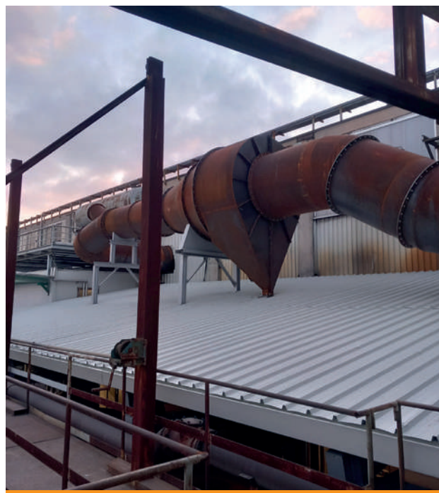
Ciclone assiale abbattimento polveri grossolane e parascintille in impianto di aspirazione e filtrazione. Italia
