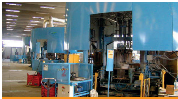
Cappe di aspirazione su conchigliatrici collegate ad impianto di aspirazione e filtrazione centralizzato – Italia
