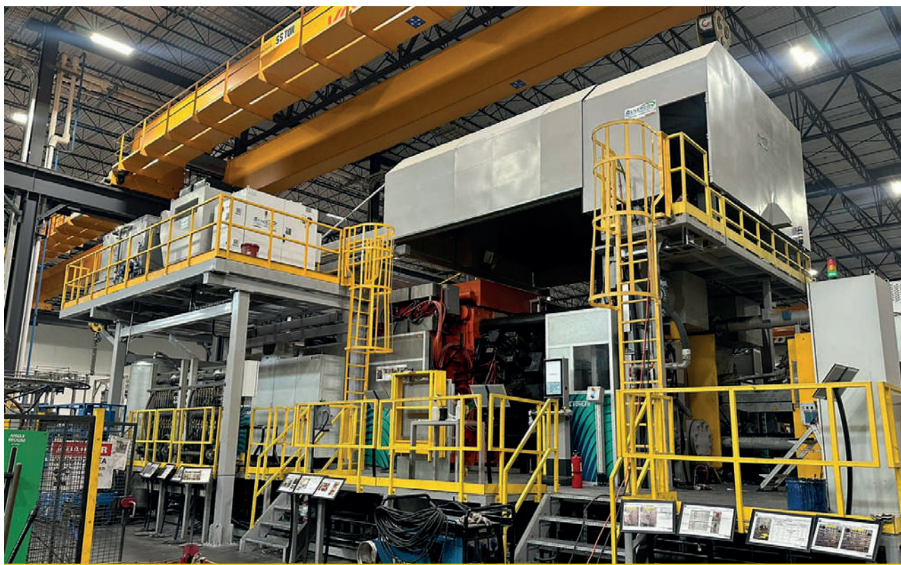
■ Cappa su macchina di pressofusione da 4500 Ton completa di filtri elettrostatici autopulenti ENERPRESS per il ricircolo dell'aria depurata in ambiente, su piattaforma indipendente da cappa – USA
