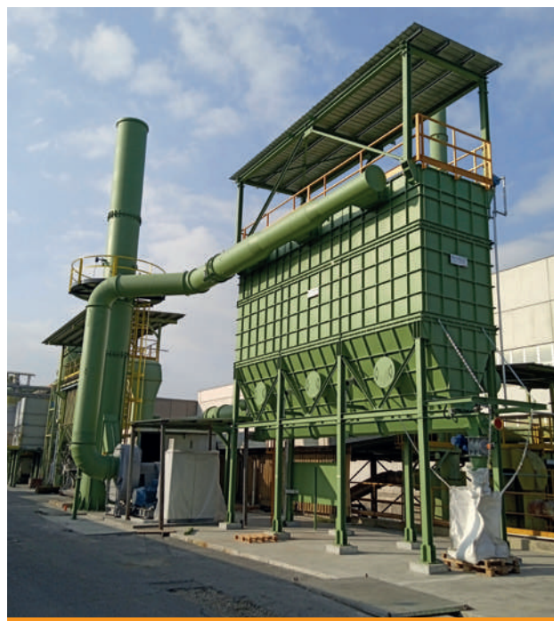
Impianto aspirazione e filtrazione fumi da forni bronzo. Italia
