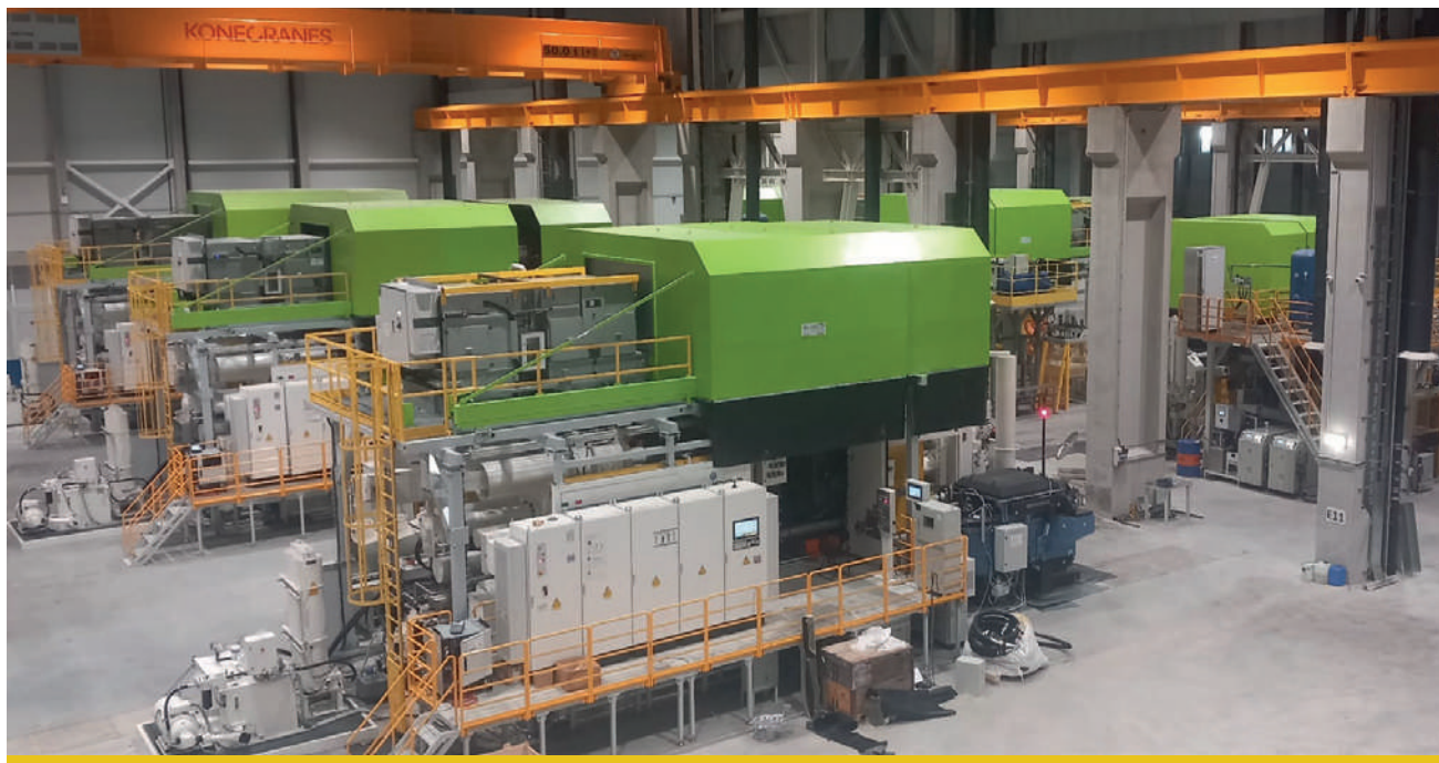
■ Cappe complete di filtri elettrostatici autopulenti ENERPRESS per il riciclo dell'aria depurata in ambiente su macchine di pressofusione da 800 a 2700 Ton – Ungheria
