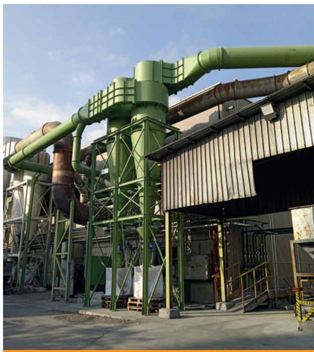
Cycloni verticali per abbattimento polveri grossolane e scintille – Italia
