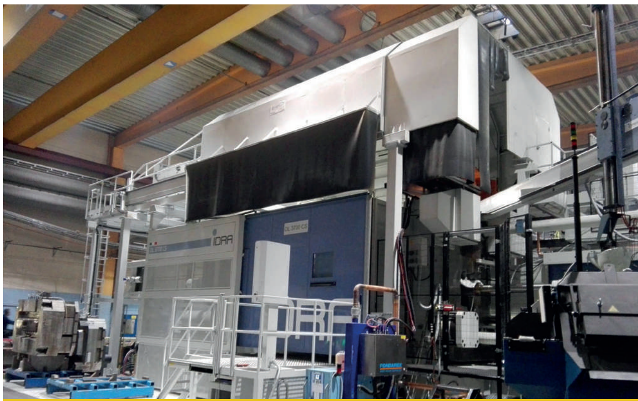
■ Cappa in due parti completa di impianto individuale di aspirazione e filtrazione ENERPRESS per il ricircolo dell'aria depurata in ambiente su macchine di pressofusione IDRA OL3700CS – Svezia
