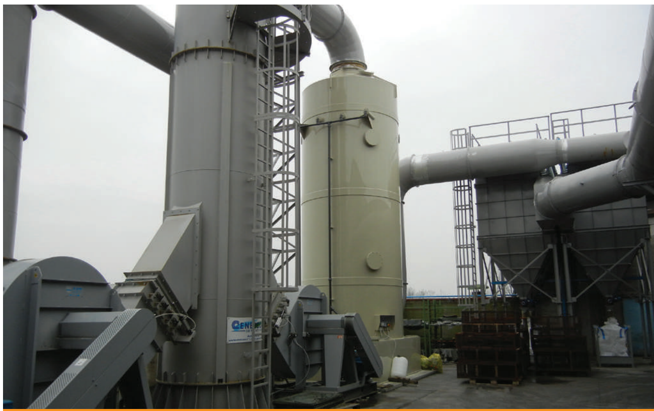
Impianti tecnologici di aspirazione, filtrazione polveri e abbattimento odori provenienti da conchigliatrici per stampaggio e forni fusori bronzo – Italia
