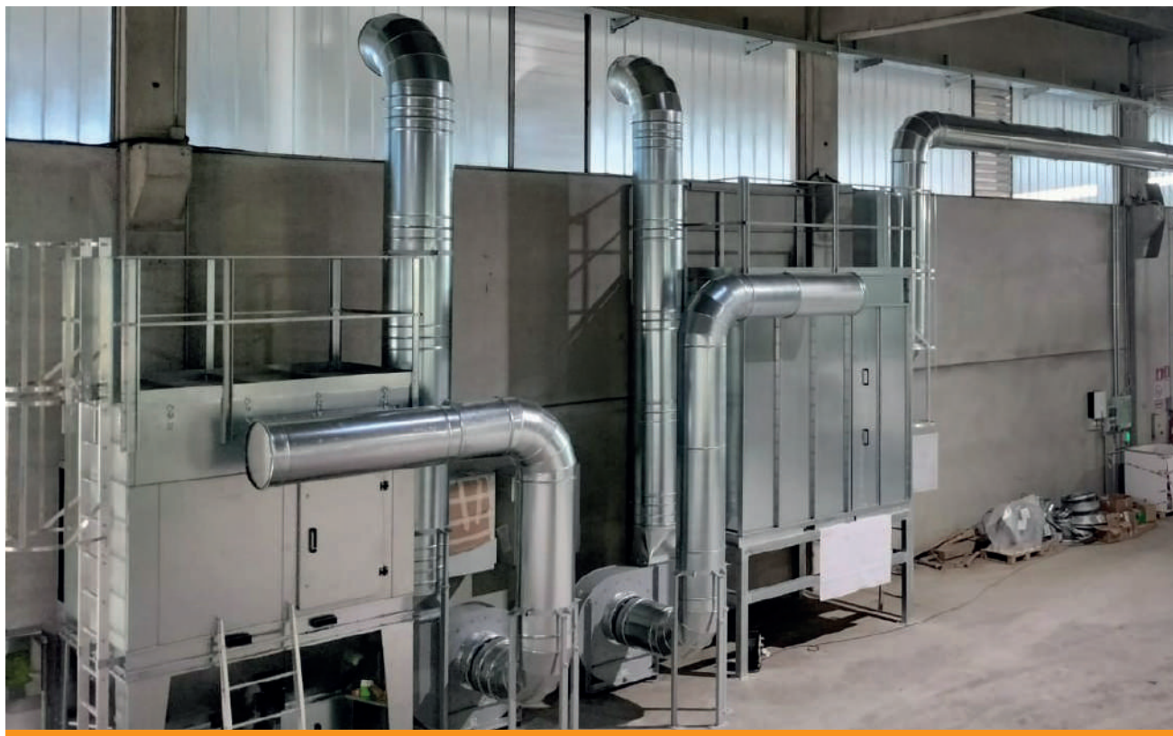
Impianti di aspirazione e filtrazione a carboni attivi e a cartucce per rispettivamente odori e polveri da trattamento rifiuti e reflui – Italia
