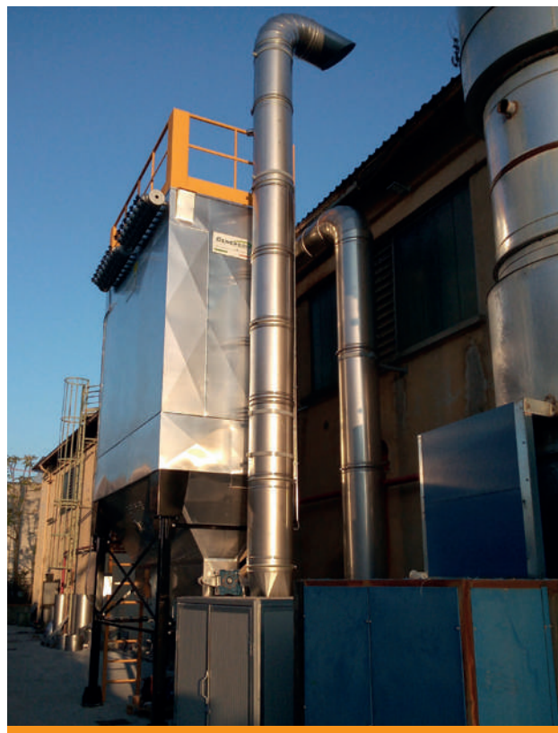
Impianto aspirazione e filtrazione fumi da forno a torre alluminio – Italia
