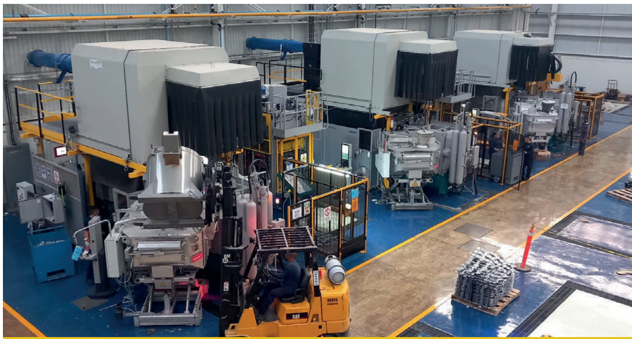
Cappe su macchine di pressofusione 800 Ton – dettaglio delle prime 3 macchine su totale di 12 presse asservite da impianto di aspirazione e filtrazione centralizzato – Messico
