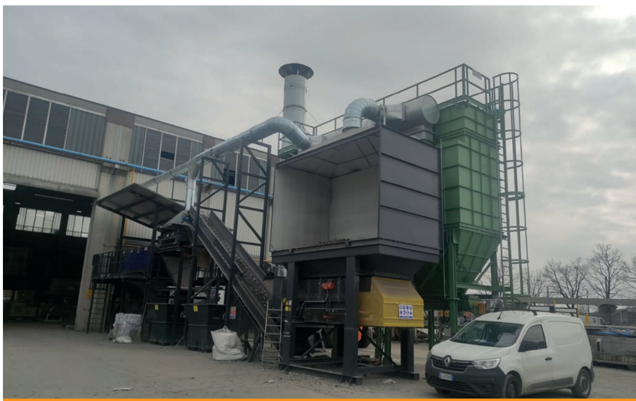
Impianto di aspirazione e filtrazione da sistema selezione rottame – Italia
