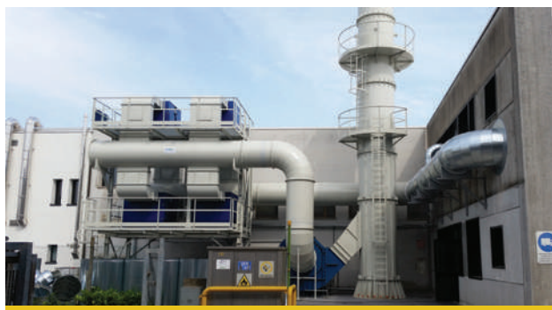
Impianto di aspirazione e filtrazione centralizzato ENERPROG in numero 4 moduli dedicato a n.7 presse. Italia
