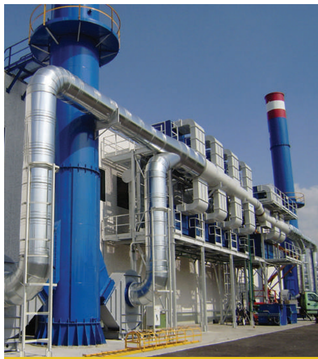
Impianto di aspirazione e filtrazione centralizzato ENERPROG in numero 12 moduli per una portata complessiva aspirata di 200.000 m 3 /h dedicato a n.22 presse – Italia
