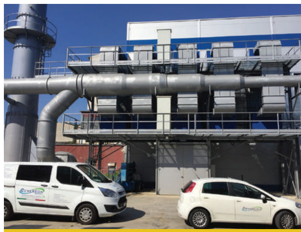
Impianto di aspirazione e filtrazione centralizzato ENERPROG in numero 10 moduli per una portata complessiva aspirata di 150.000 m 3 /h dedicato a n.19 presse – Slovacchia
