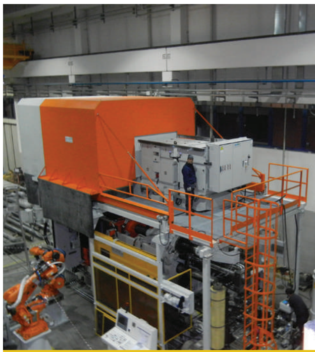
Cappa in due parti completa di impianto individuale di aspirazione e filtrazione ENERPRESS per il riciclo dell'aria depurata in ambiente su macchina di pressofusione – Russia
