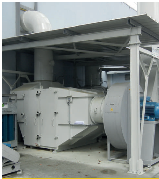
Impianto di aspirazione e filtrazione centralizzato da 80.000 m 3 /h dettaglio del filtro a coalescenza – Italia
