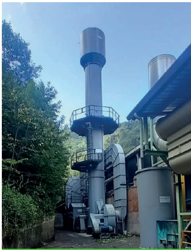
■ Silenziatore per attenuazione rumore in uscita da camino impianto di aspirazione e filtrazione nebbie asservente 10 presse – Italia
