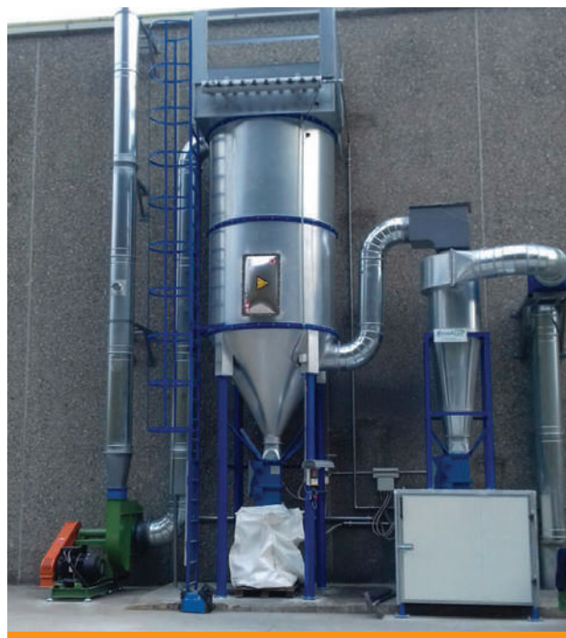
Impianto aspirazione e filtrazione da polveri taglio alluminio – 6.000 m 3 /h
